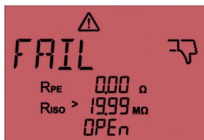
Fig. 47: Misurazione non superata. Sul display viene visualizzato "OPE n ". Collegamento del conduttore interrotto/interruttore aperto
